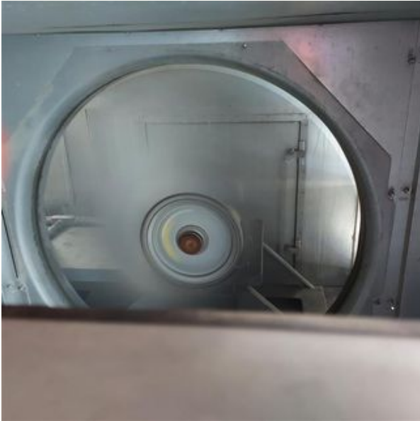
HVAC System Return Fan
