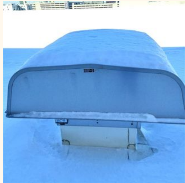
Stairwell Pressurization Fan
