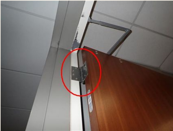
Unstable Hinge on Door
