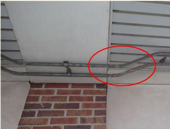
Corrosion on Conduits
