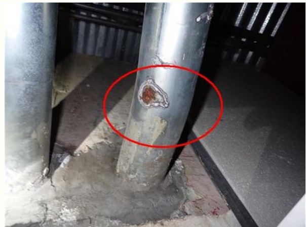
Corrosion on Feeder Conduit
